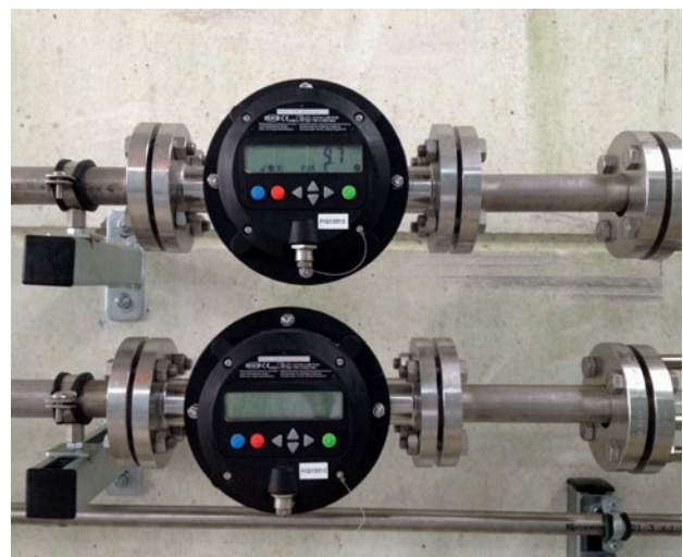
FMO 150 mit Flanschanschluss eingebaut in einer Rohrleitung.
